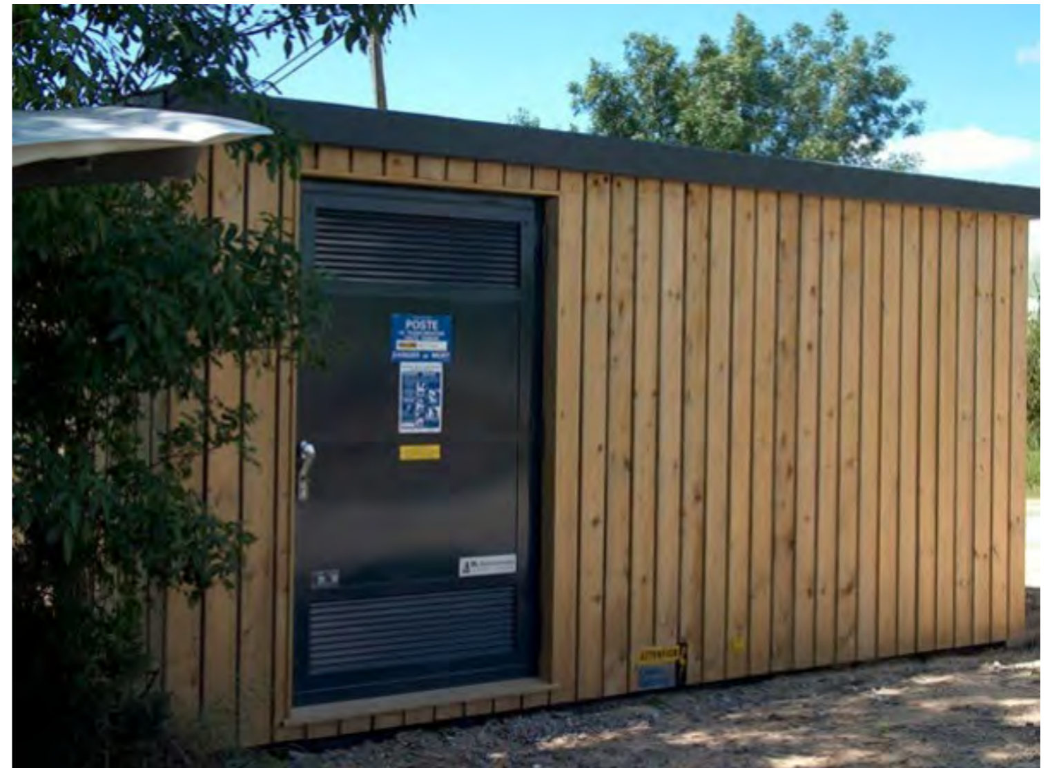
Fig. 197 : 2 Exemples de postes de livraison en bardage bois
